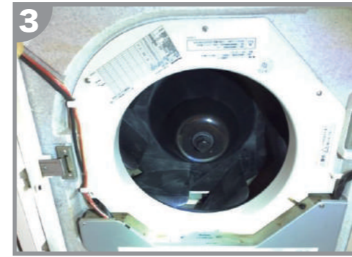
業務用エアコン内部フィルター 外した状態 内部、吹き出し口に目立った汚れは無し
