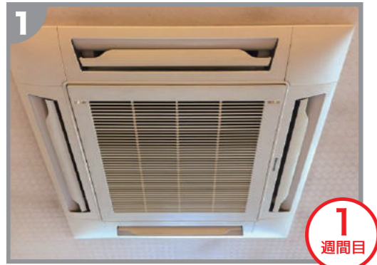
エアコンフィルター 貼り付け状況写真 ダスキンにてエアコン内部清掃後エアコンフィルター無し
